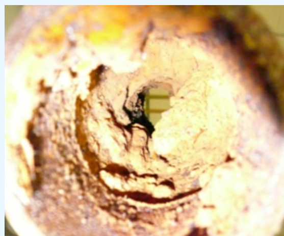
Depuneri de calcar într-o conductă de încălzire, reducere semnificativă a diametrului.
