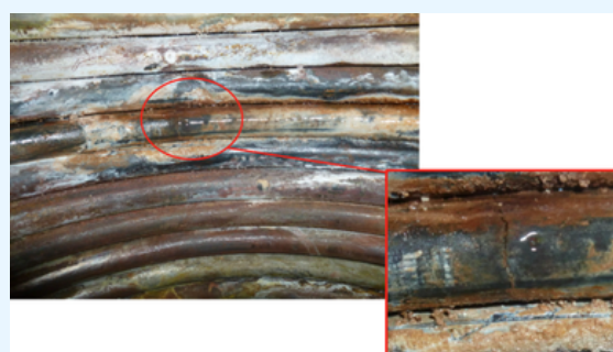
Calcarul de pe suprafețe duce la diferențe mari de temperatură în schimbătorul de căldură - stresul termic provoacă fisuri cu scurgeri.
